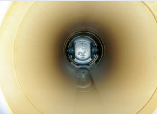
Abb. 6: Leitung nach Mischer (Betrieb 6 Monate)
