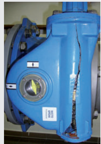
Abb. 3: Riss im Gehäuse
