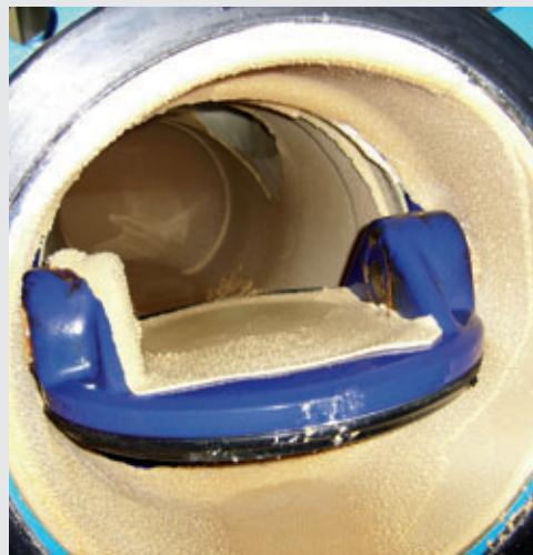
Abb. 2: Absperrklappe mit Kalkablagerungen
